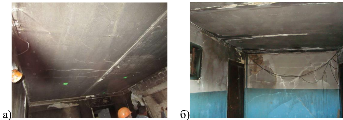
Фото 2 (а-б). Розтріскування оздоблювального шару та кіптява на конструкції перекриття
