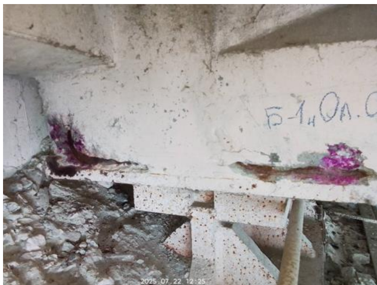
Рис. 1. Розкриття бетону балки Б-1н на опорі №0 зі сторони нижнього б'єфу Корозія арматурної сталі на глибину до 1 мм по поверхні. Глибина карбонізації бетону до 10 мм. Засмічення опорних частин
