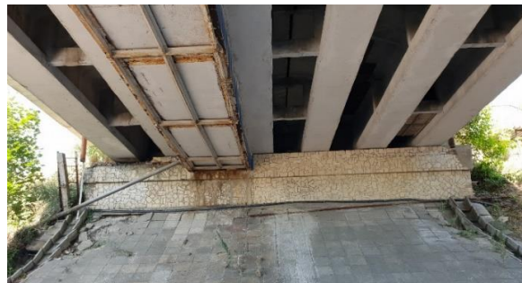
Рис. 5. Руйнування укріплення-опорядження відкошу насипу (просідання сторін бетонної плитки) та лотків з обох сторін укусу
