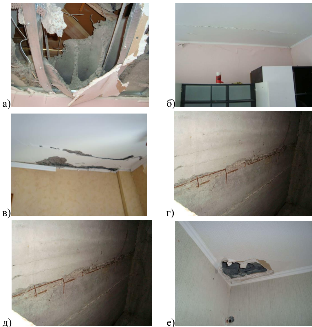
Фото 1 (а-е). Виявлені пошкодження збірних залізобетонних перекриттів
