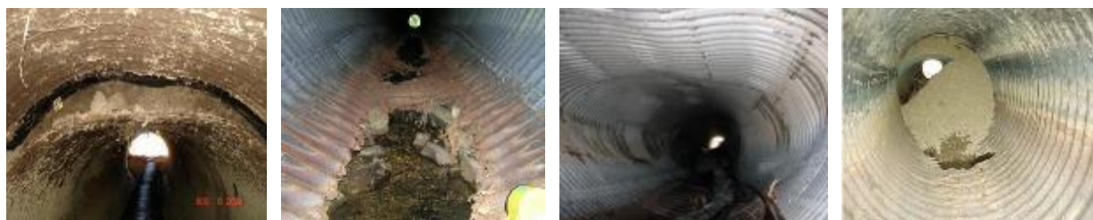
Рис. 1 — Пошкодження споруд від корозії та абразивного стирання: дефектів з'єднань; зношення внутрішньої частини споруди; спотворення форми; міграції ґрунту)
