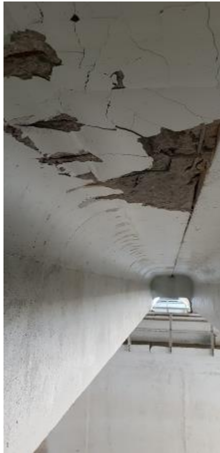
Рис. 3. Руйнування, тріщиноутворення прогону після ракетного удару
