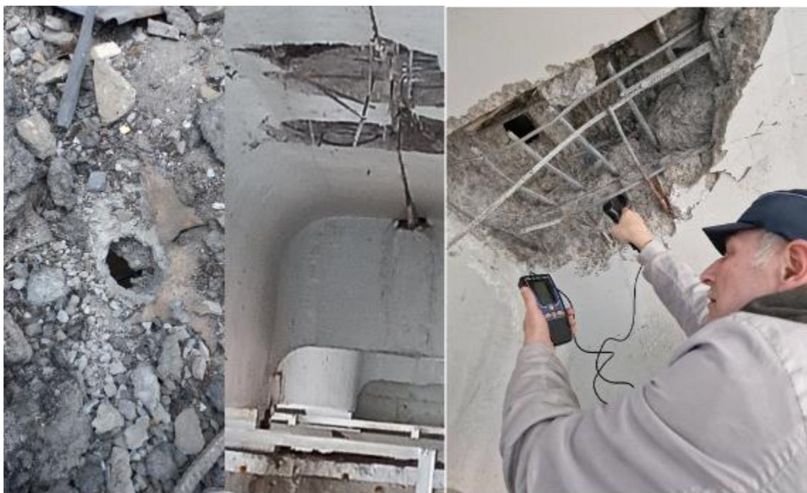
Рис. 1. Типові руйнування залізобетонних балок прогонових будов
