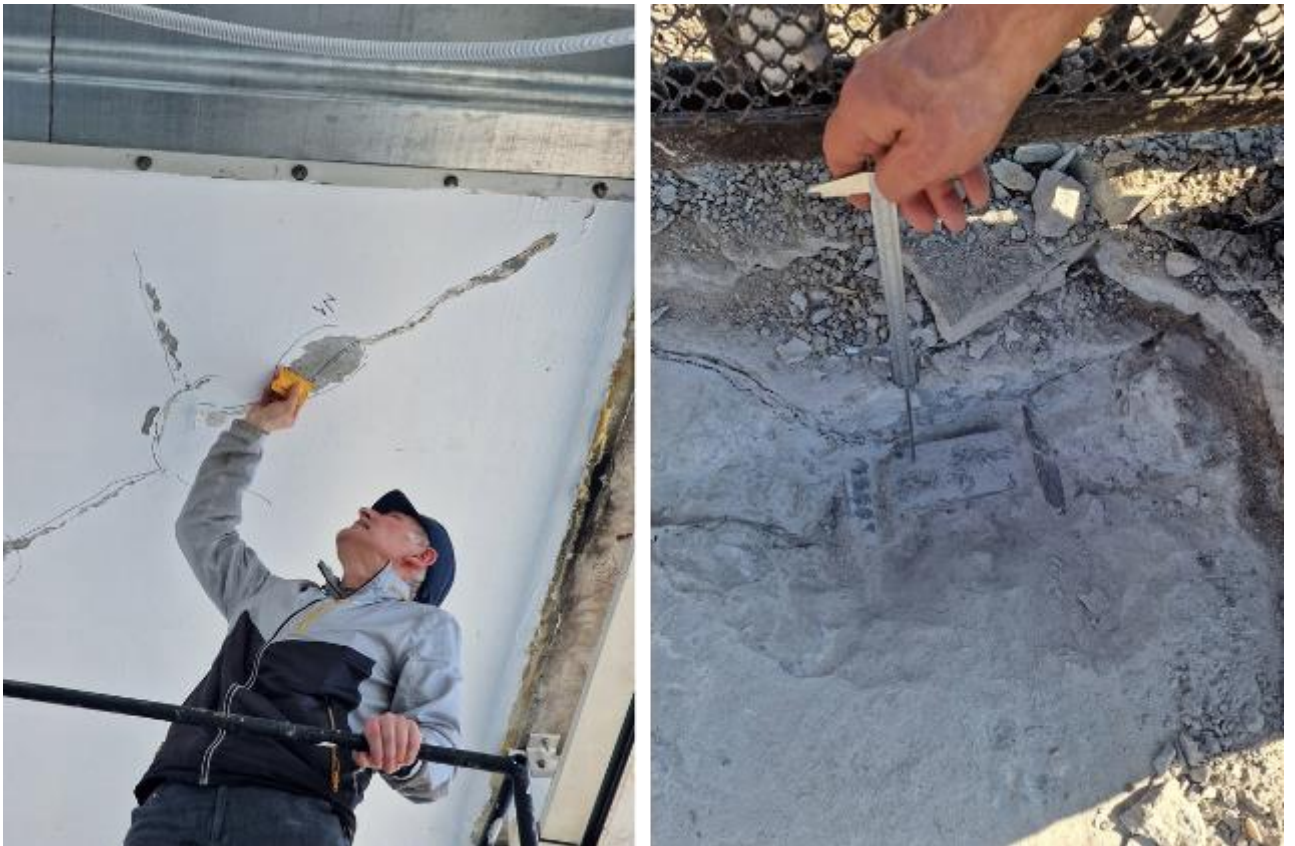
Рис. 5.Тріщиноутворення в залізобетонній плиті будівлі
