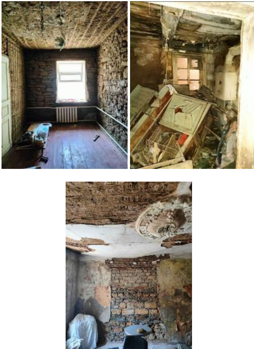
Рис. 4. Характерні пошкодження будівельних об'єктів
