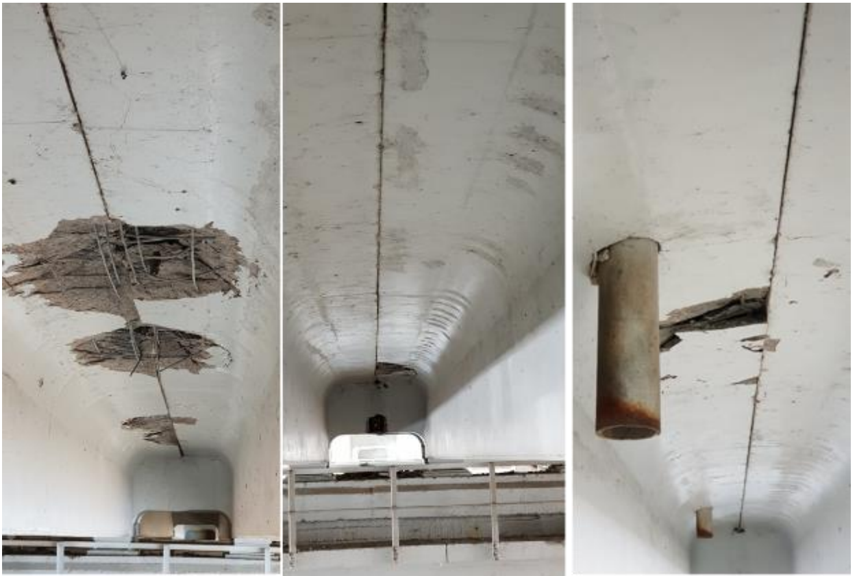
Рис. 2. Фотофіксація руйнувань залізобетонних балок знизу
