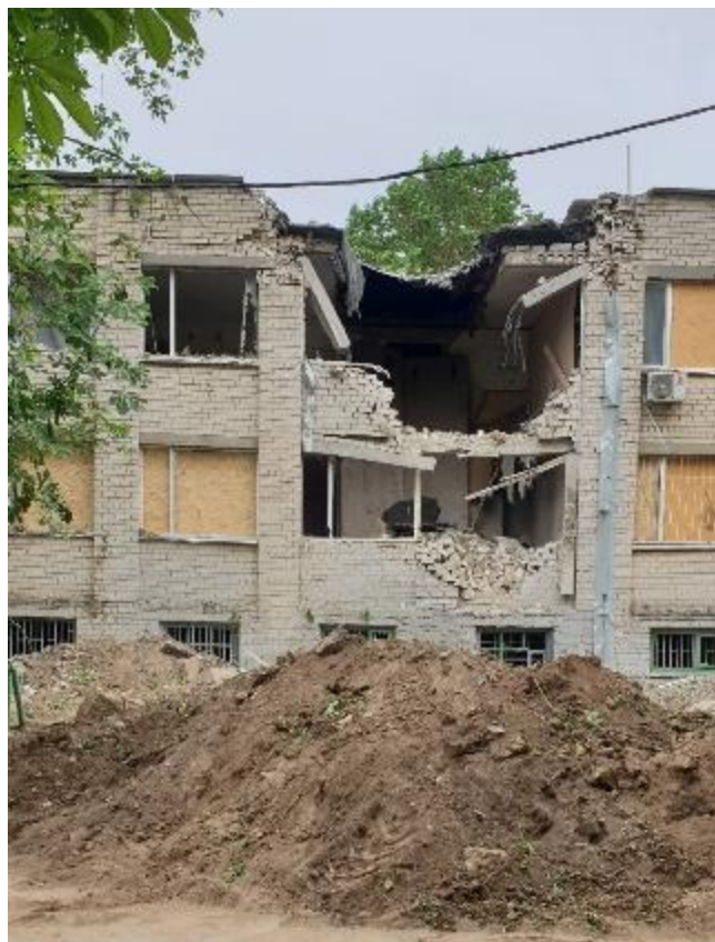
Рис. 1. Руйнування і пошкодження від ракетного удару корпусу університету
