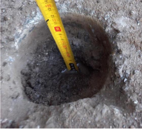
Рисунок 7 - Застій води під асфальтобетонним покриттям проїзної частини, зволоження нижнього шару
