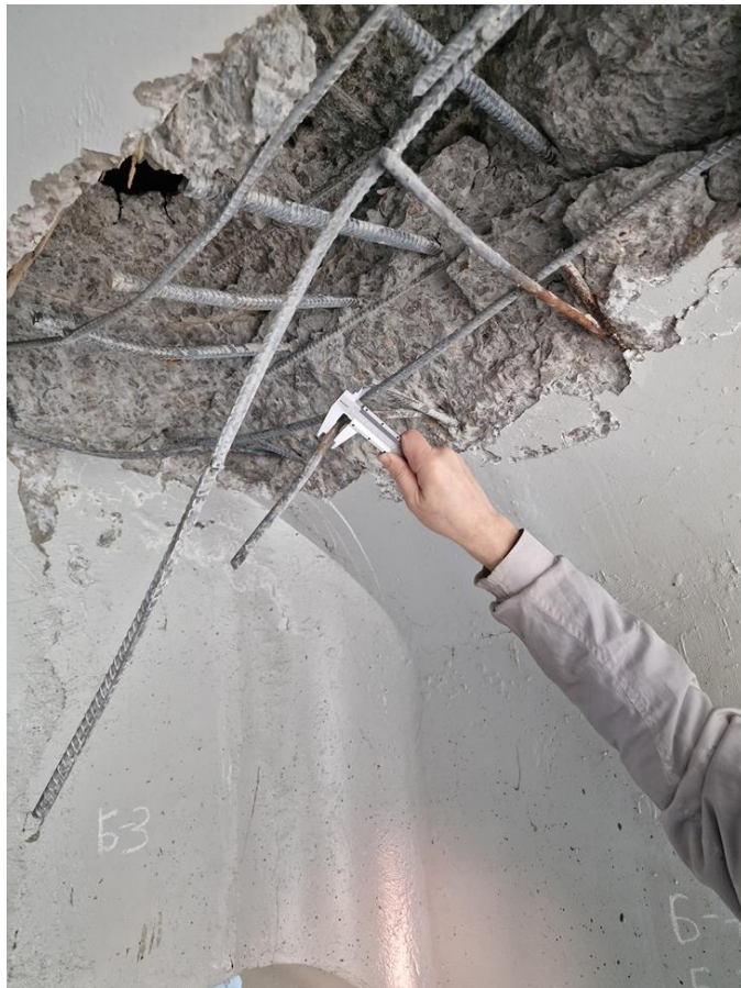
Рисунок 2 – Вивал бетону, деформації і відгини арматури
