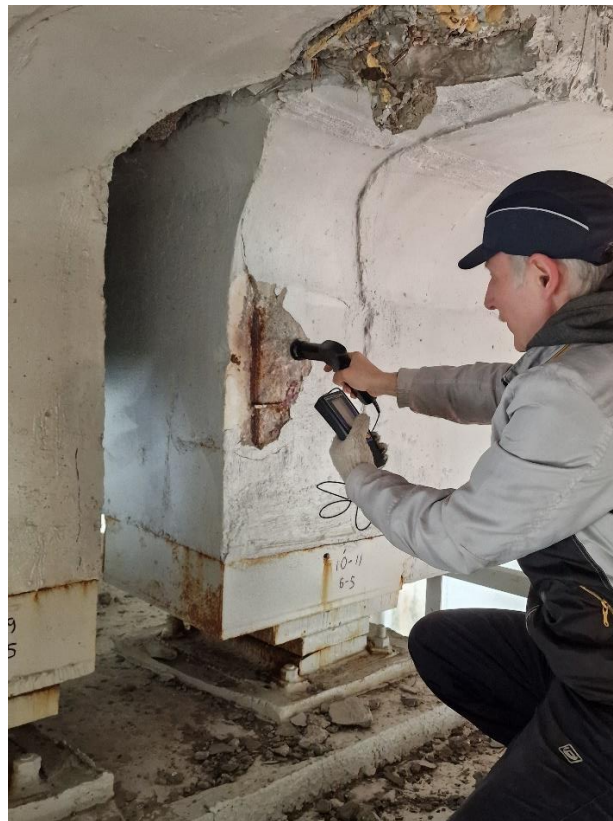
Рисунок 4 – Порушення захисного шару бетону, оголення корозія арматури, визначення залишкової міцності бетону
