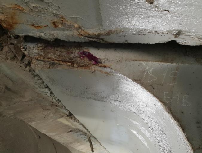
Рисунок 6 - Руйнування захисного шару бетону, корозія арматури
