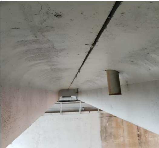
Рисунок 9 - Корозія сталевих труб водовідведення з проїзної частини, недостатня довжина труб водовідведення, що є меншою за проектну
