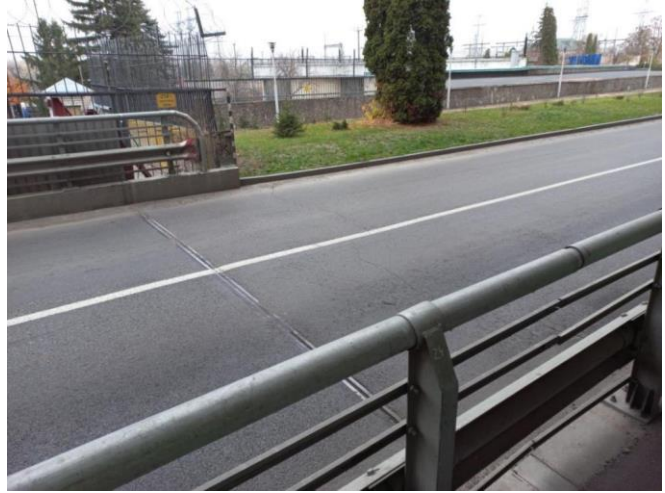
Рисунок 8 - Поперечні тріщини до 4 мм в асфальтобетонному покритті підходів проїзної частини
