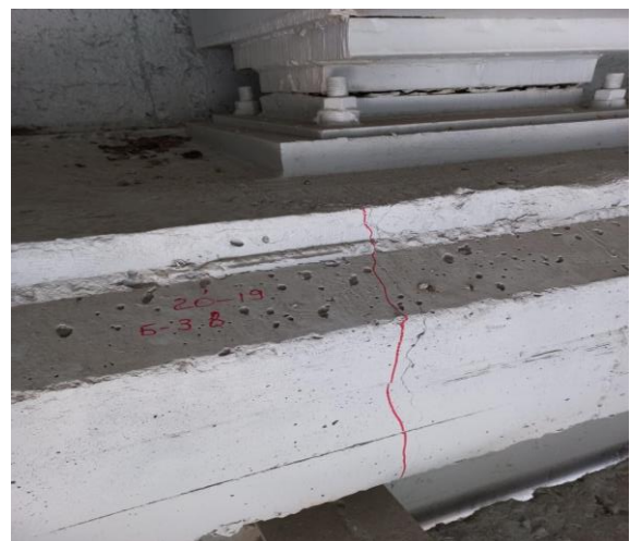
Рисунок 5 - Вертикальна тріщина в монолітному залізобетонному ригелі
