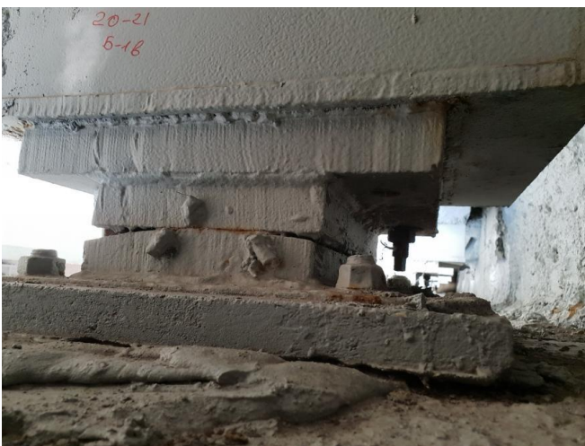
Рисунок 4 - Поверхнева корозія закладних деталей і опорних балансирів балки, зазори на місці бетонної підливки
