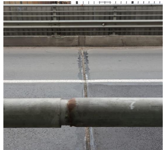
Рисунок 10 - Часткова корозія елементів бар'єрної огорожі
