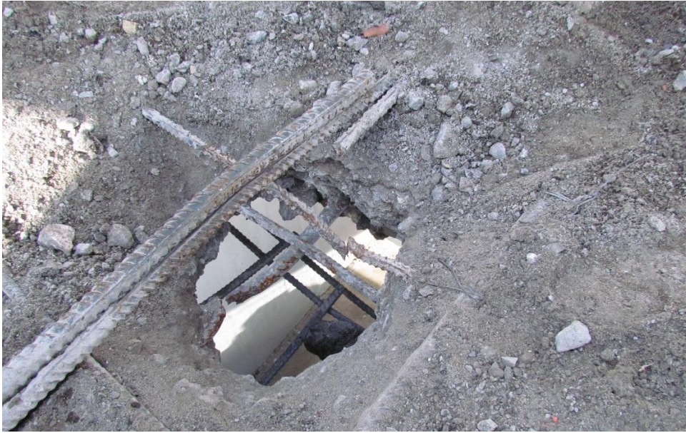
Рисунок 1 – Наскрізний отвір в плитній частині автопроїзду гідротехнічної споруди
