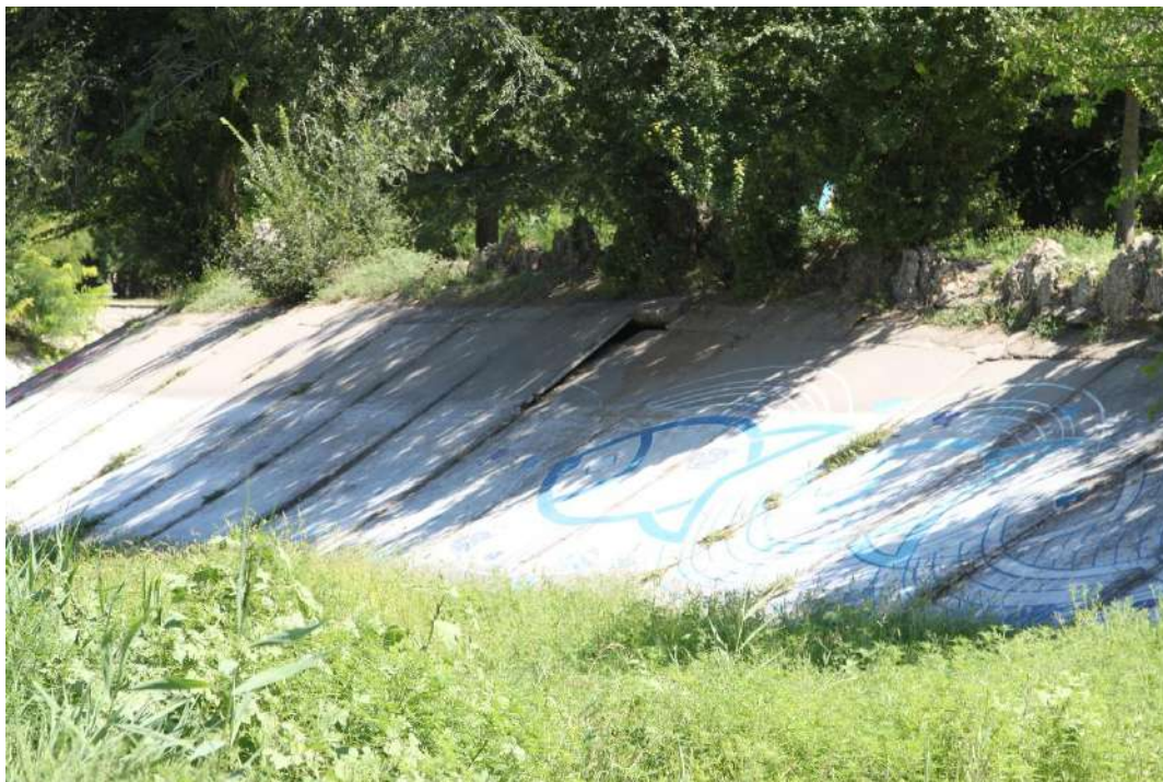
Рис. 2. Під окремими плитами є повітряний проміжок, не забезпечена «постіль» для їх обпирання
