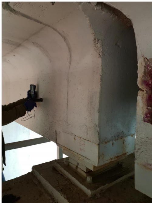
Рис. 1. Визначення міцності бетону балки Б-5 на опорі 8 неруйнівним методом за допомогою електронного приладу BetonProCONDROL
