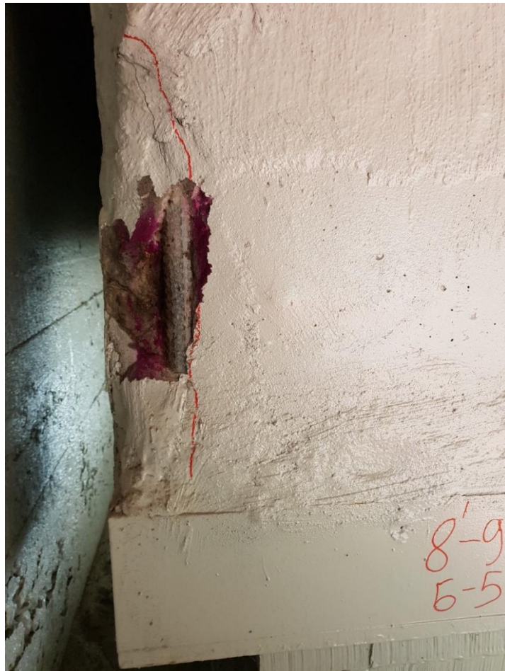
Рис. 2. Ділянка розкриття: Балка Б-5, опора 8. Вертикальна арматура діаметром 32 мм А-ІІ. Продукти корозії арматури до 1 мм. Карбонізація бетону до 55 мм
