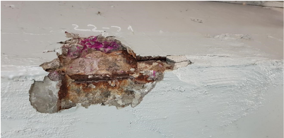
Рис. 3. Розкриття плитної частини балки Б-5 прогону 22-21. Корозія арматури до 1,8 мм, карбонізація бетону на глибину розкриття 35 мм. Ремонтний склад не карбонізований.
