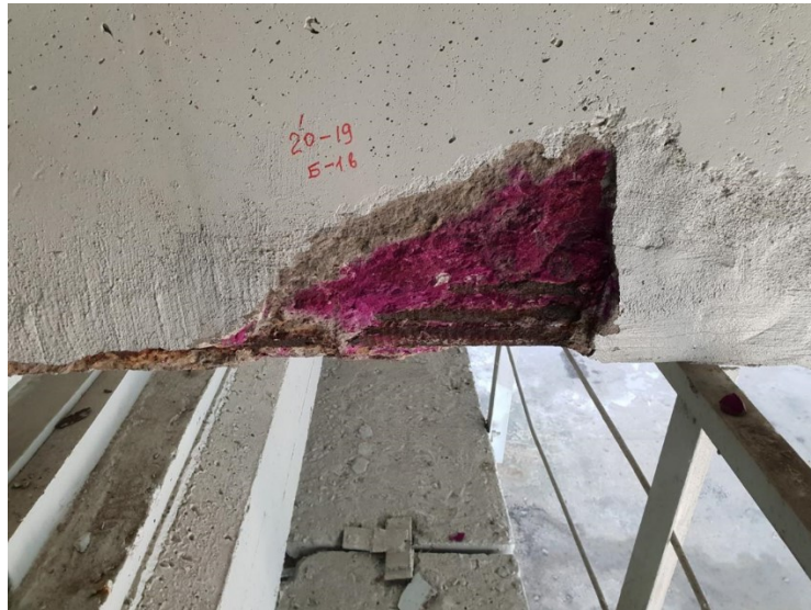
Рис. 1. Ділянка розкриття ребра балки Б-1 біля опори 20. Глибина карбонізації бетону не менше 25 мм. Продукти корозії поздовжньої арматури до 4 мм.
