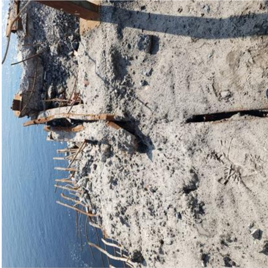
Рис.2. Зруйнований шар бетону, оголена арматура крайки тротуару в прогоні і на опорі моста, відірвана ділянка деформаційного шва зі сторони нижнього б'єфу після ракетно/дроновогоудару
