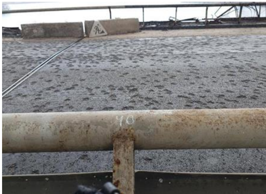
Рис. 7. Через вибуховий удар наскрізні отвори в балці бар'єрного огороження зі сторони верхнього б'єфу, корозія сталі, вибоїни в асфальтобетонному покритті проїзної частини по усій ширині в прогонах
