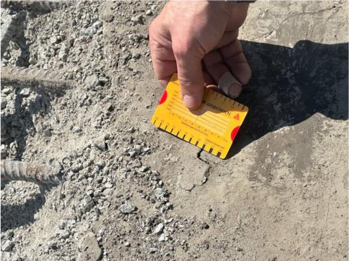
Рис. 4. Тріщина у верхньому шарі під гідроізоляцією розкриттям до 2,5 мм
