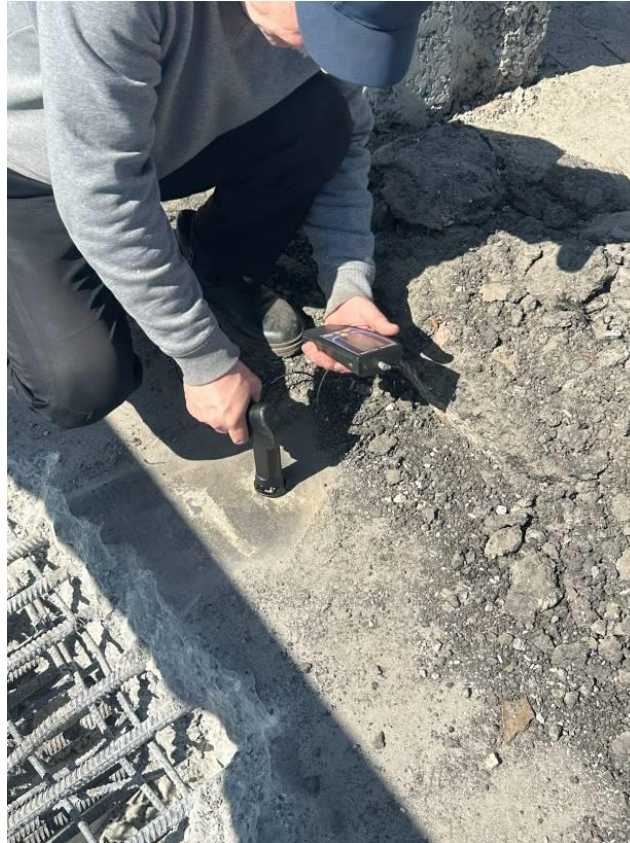
Рис. 6. Руйнування бетону в плитній частині балок прогонової будови
