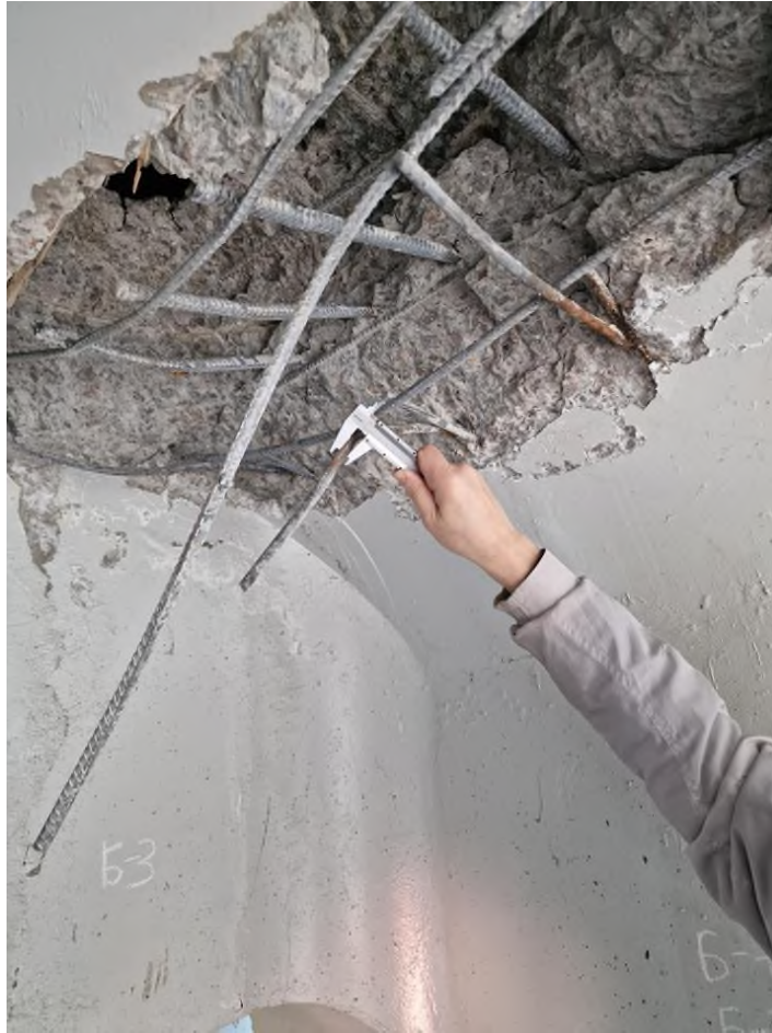
Рис. 5. Вихідний отвір з вивалом бетону на зворотному боці плити
