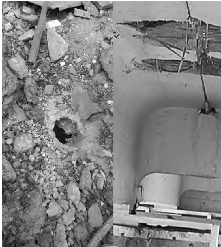
Рис. 7. Типові руйнування залізобетонних балок прогонових будов
