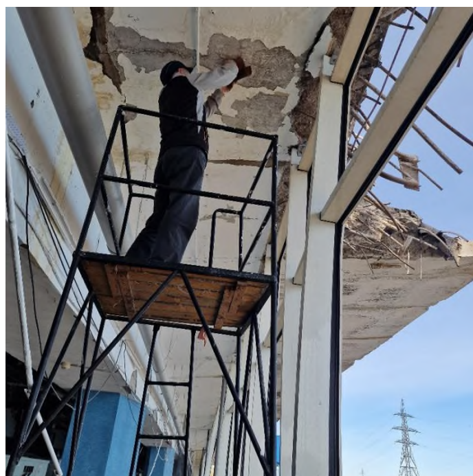
Рис.2. Характерне тріщиноутворення в залізобетонній плиті після ракетного удару
