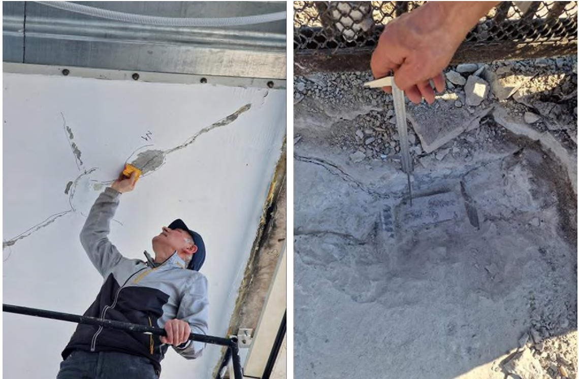
Рис. 3. Тріщини в залізобетонній плиті силового покриття будівлі
