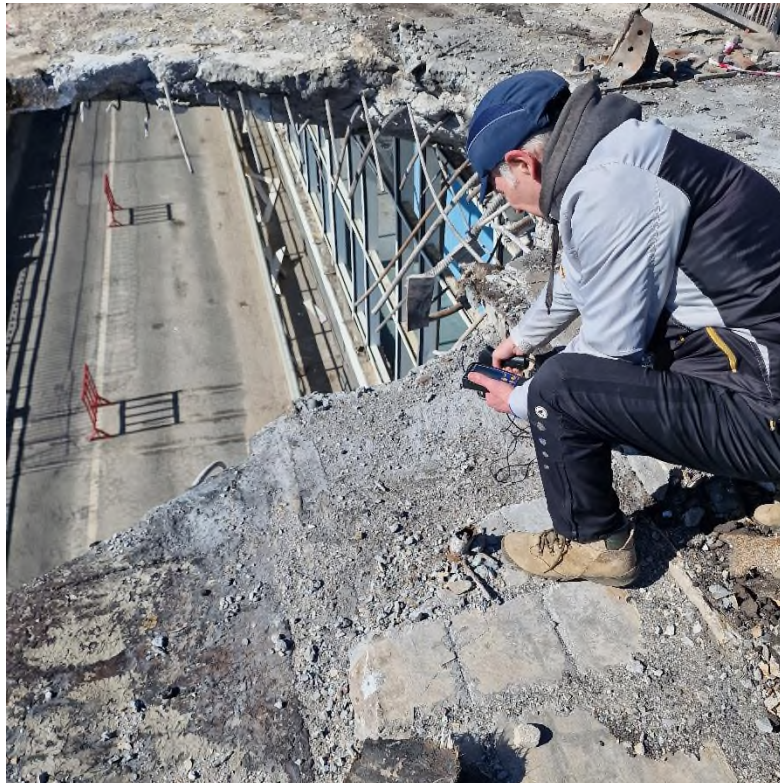
Рис.1. Наслідки ракетного удару — руйнування плити покриття, проведення контролю міцності бетону
