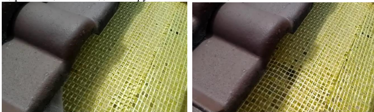
Рис. 1. Зображення зруйнованої під покрівельної гідроізоляції:
