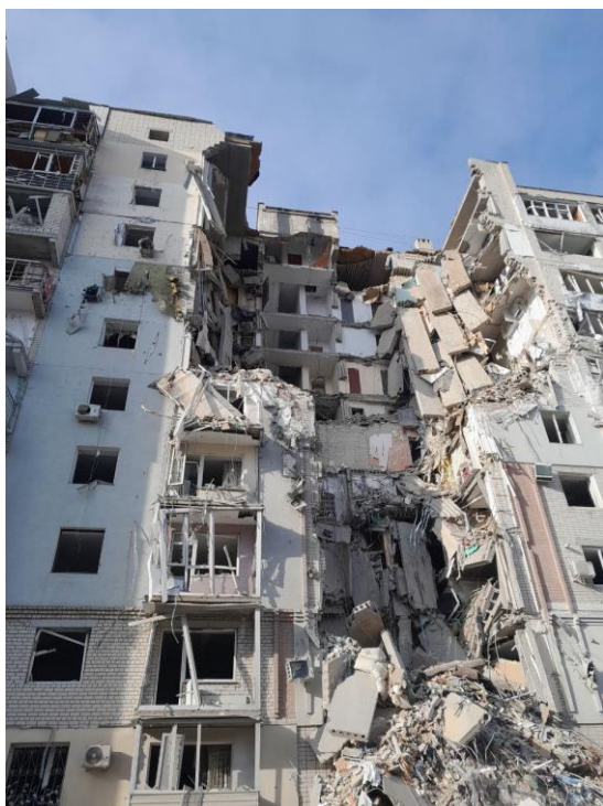
Рис. 1. Пошкодження будівлі авіаударом (вигляд спереду)
