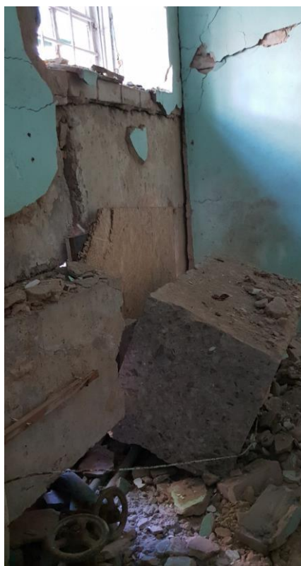
Рис. 4. Руйнування фундаменту будівлі під дією ударної хвилі, спричиненої ракетним ударом по ґрунту
