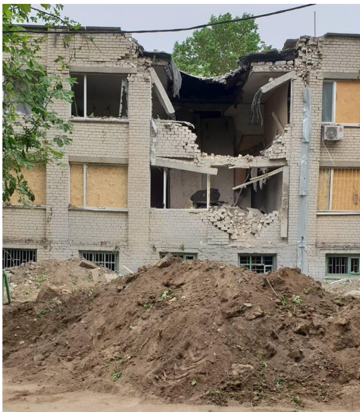
Рис. 3. Руйнування будівлі внаслідок ракетного удару, завданого поблизу деформаційного шва
