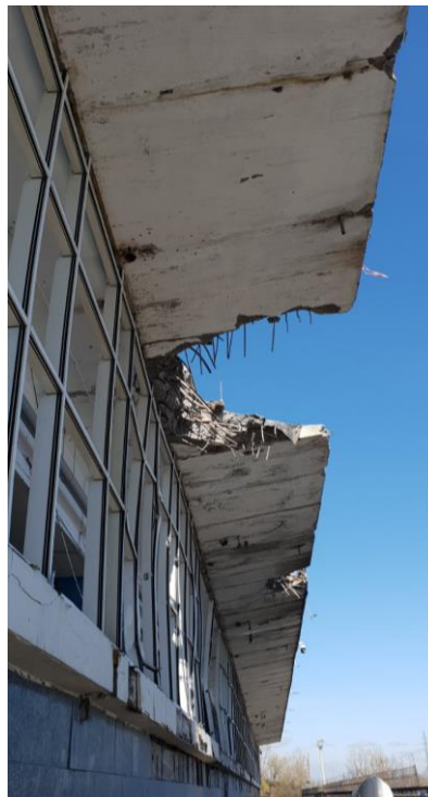
Рис. 2. Руйнування залізобетонної консольної частини плити. Вид знизу
