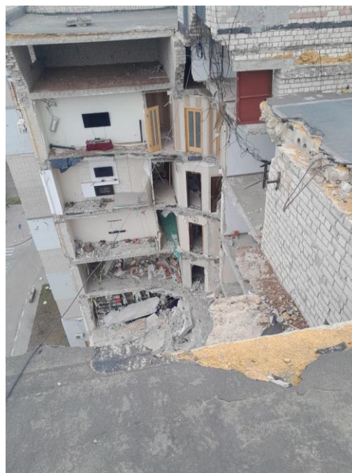
Рис. 2. Пошкоджена будівля (вигляд зверху)
