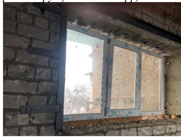
Фото 7. Розширення існуючих віконних прорізів з підсиленням зі встановленням металопластикових віконних блоків з потрійним склінням
