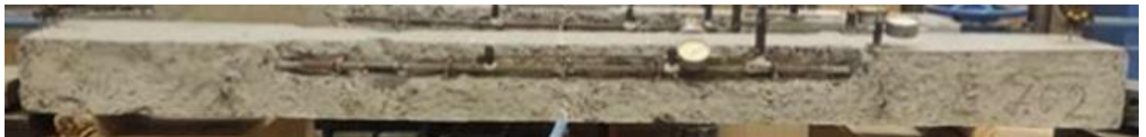
Рис. 4. Залізобетонний елемент з арматурою оголеною по центру
