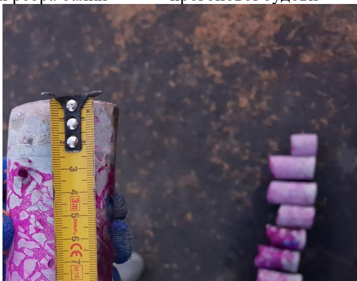
Рис. 3. Карбонізація бетону на глибину до 30 мм
