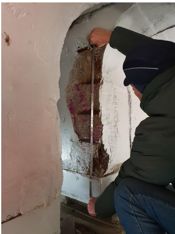
Рис. 1. Карбонізація бетону, корозія арматури ребра балки
