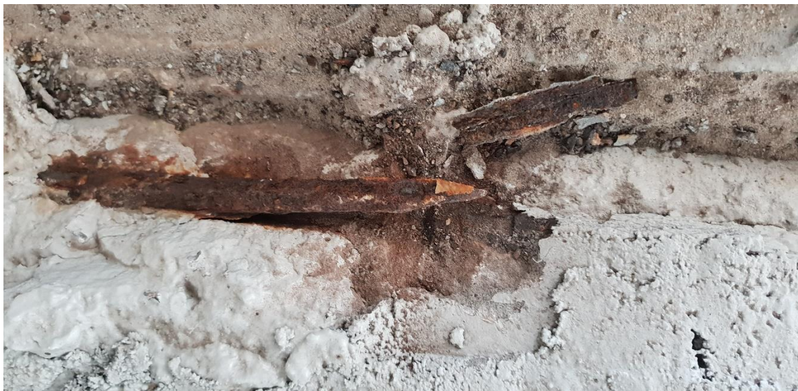
Рис. 5. Розрив арматури через корозію сталі і карбонізацію бетону
