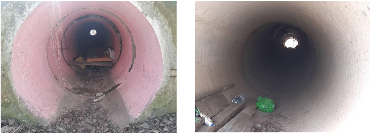
Рис. 2. Стан водопропускної труби
