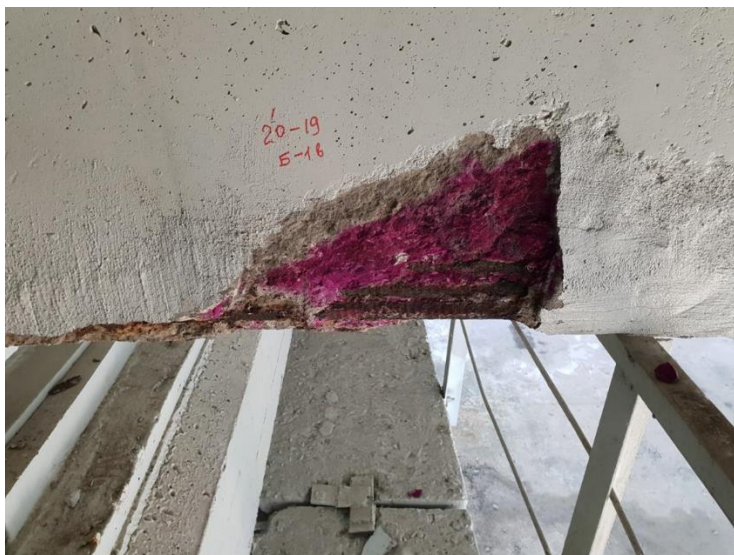
Рис. 1. Ділянка розкриття ребра балки Б-1 біля опори 20. Глибина карбонізації бетону не менше 25 мм. Продукти корозії поздовжньої арматури до 4 мм.
