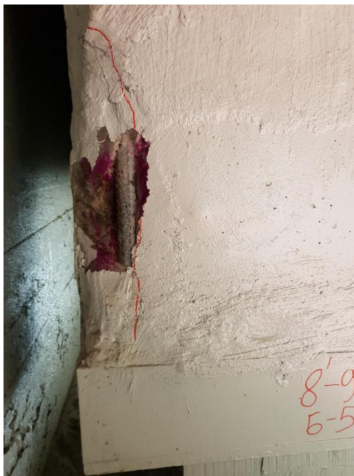
Рис. 2. Ділянка розкриття: Балка Б-5, опора 8. Вертикальна арматура діаметром 32 мм А-ІІ. Продукти корозії арматури до 1 мм. Карбонізація бетону до 55 мм
