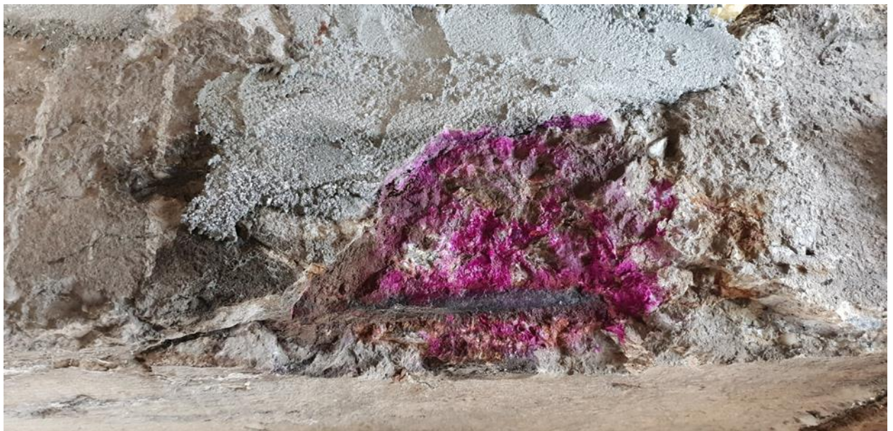
Рис. 3. Балка за віссю 26 монолітної плити ПМ-26-27 в прольоті в осях Б-В. Карбонізація до 10мм. Корозія арматурної сталі.
