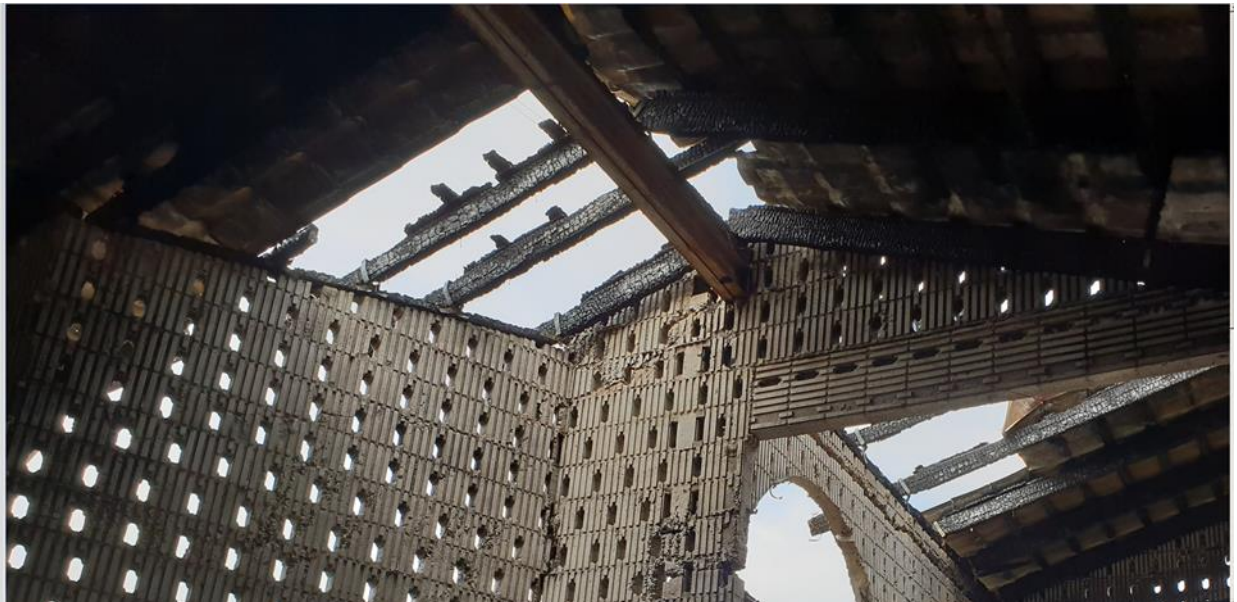
Рис.3. Вид з другого поверху. Кровляна система покрівлі вигоріла.
