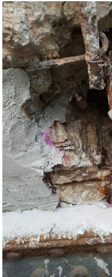
Рис. 5. Консольна частина плити ПС-10-11в-8 біля осі Г зі сторони верхнього б'єфу. Карбонізація бетону на всю висоту перерізу. Корозія. Стрижень розрізаний.
