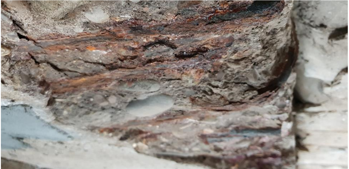
Рис. 4. Консольна частини збірної плити ПС-4-5н-16 в осях Б-В. Карбонізація. Корозія арматури до 70%.
