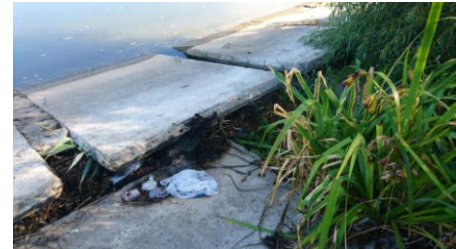
Рис. 4. Підмив основи берегоукріплення
