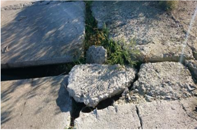
Рис. 2. Руйнування бетону плит облицювання каналу
