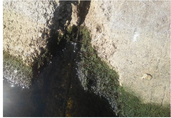
Рис. 3. Стан деформаційного шва
