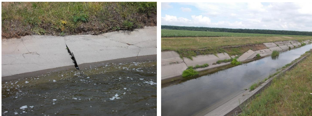
Рис. 2. Руйнування і сповзання залізобетонних плит по укосу каналу
