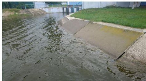
Рис. 2. Руйнування швів берегоукріплення
