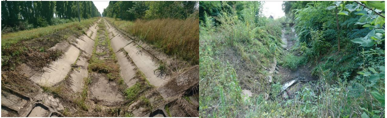
Рис. 1. Характерні пошкодження на зрошувальних каналах
