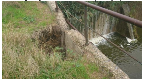
Рис. 4. Руйнування низового укосу дамби в примиканні до водоскиду
