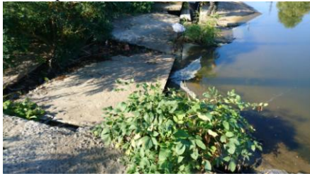
Рис. 3. Характерні пошкодження кріплення верхового укосу дамби
