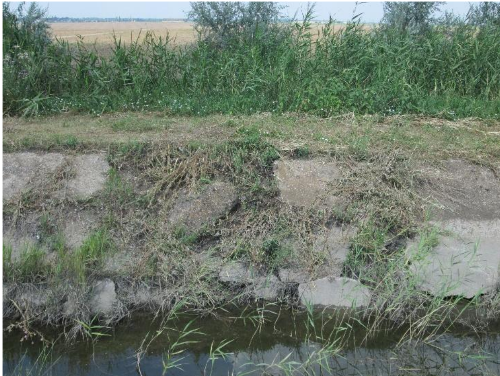
Рис. 1. Руйнування облицювання із монолітного бетону
