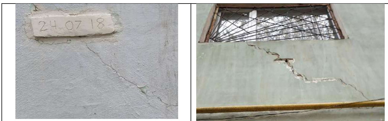
Рисунок 3 – Фіксація розвитку тріщин гіпсовими маяками
